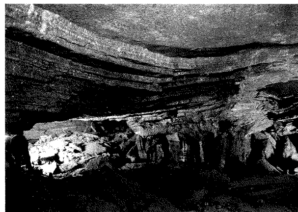
FIG. 4 Toit et piliers dans les galeries les plus extérieures du quartier effondré (source : archives CSME). Roof and pillar close to the external abutment in the collapsed panel (source : archives CSME).
