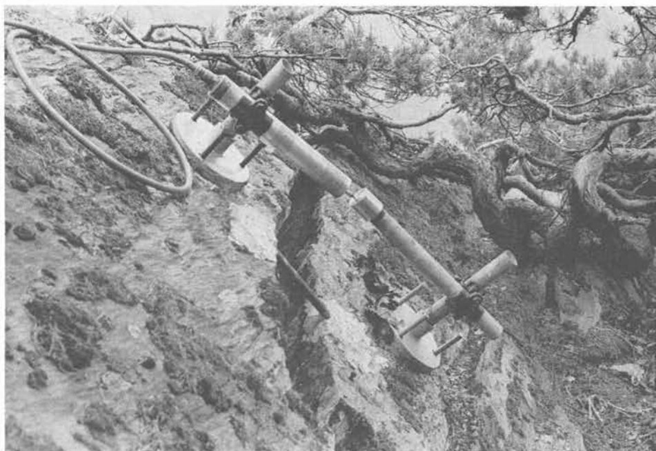
Fig. 4. — Capteur de déplacement (Tedep) en place sur une fissure ouverte délimitant un compartiment instable de la falaise.
