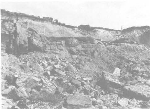
Fig. 6 Effondrement de la falaise
