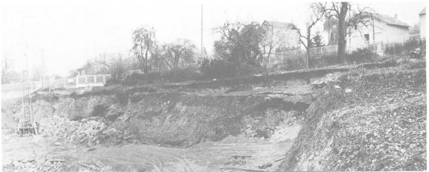
Fig. 1 - Vue générale du talus glissé (A)
