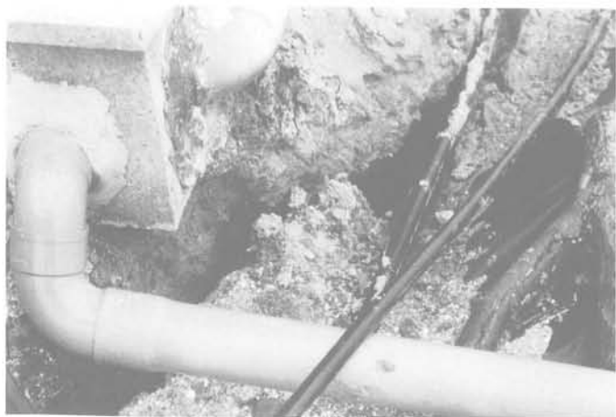
Fig. 7 - La rupture au pied de la façade (B)
