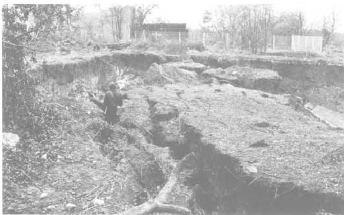
Fig. 3 - La dénivellation au droit de la rupture.
