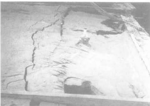
Fig. 7. — Fissures de surface après rupture du massif cloué.
