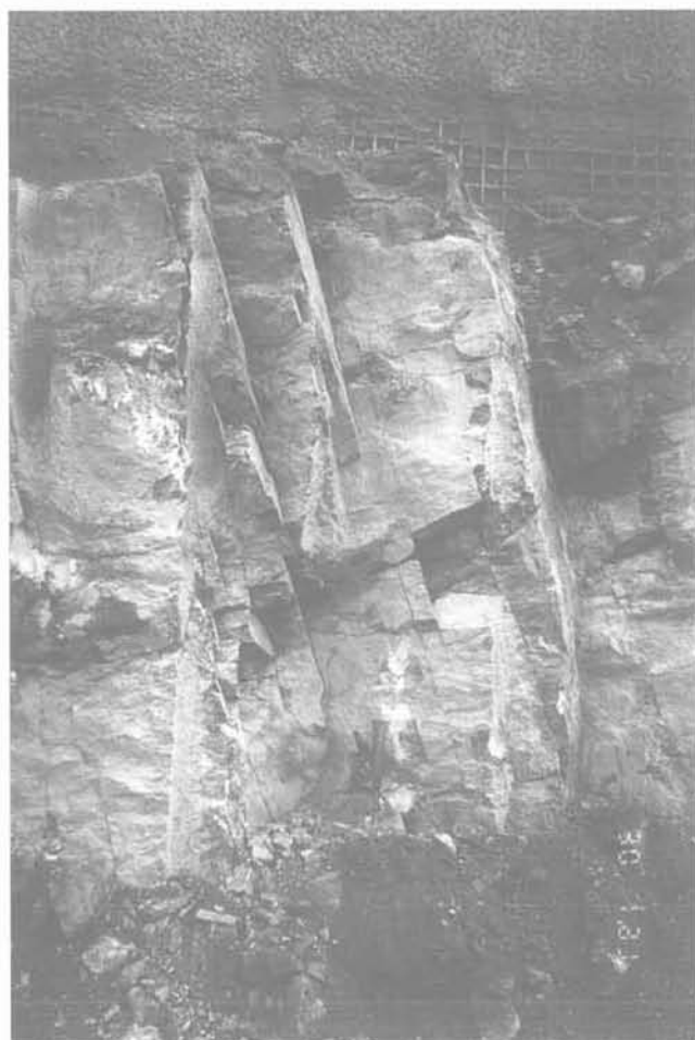
FIG. 7 Fracturation du massif rocheux. An example of rock mass joints.
