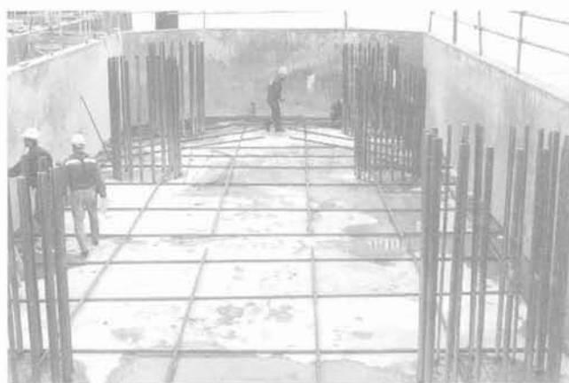
FIG. 10 Vue intérieure d'un caisson de fondation avec la partie supérieure des cages d'armatures des pieux battus. Inside of a precast foundation caisson with top of pile cages protruding.
