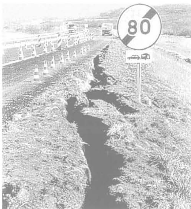
FIG. 5 Vue générale du site en 1995. Landslide zone in 1995.
