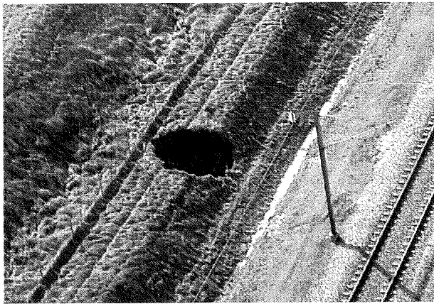
FIG. 2 Fontis dans le talus ferroviaire. Sinkhole in the railway embankment.
