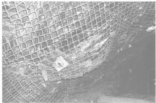
Fig. 33 Désordres dans le secteur de la naissance droite de la voûte
