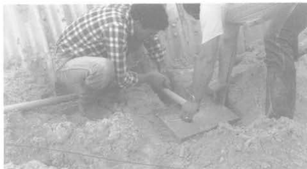
Fig. 5(b). — Mesures de déplacements horizontaux: plot de béton et tube de P.V.C
