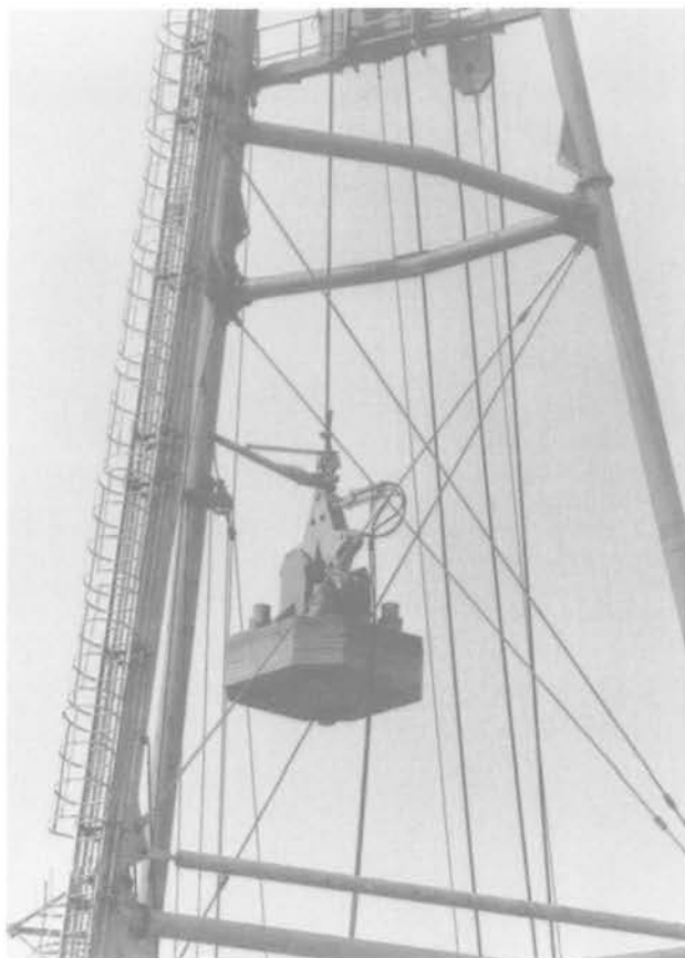
Fig. 10. — Vue partielle du tripode permettant de détailler le pilon retenu par sa pince hydraulique pendant son levage.
