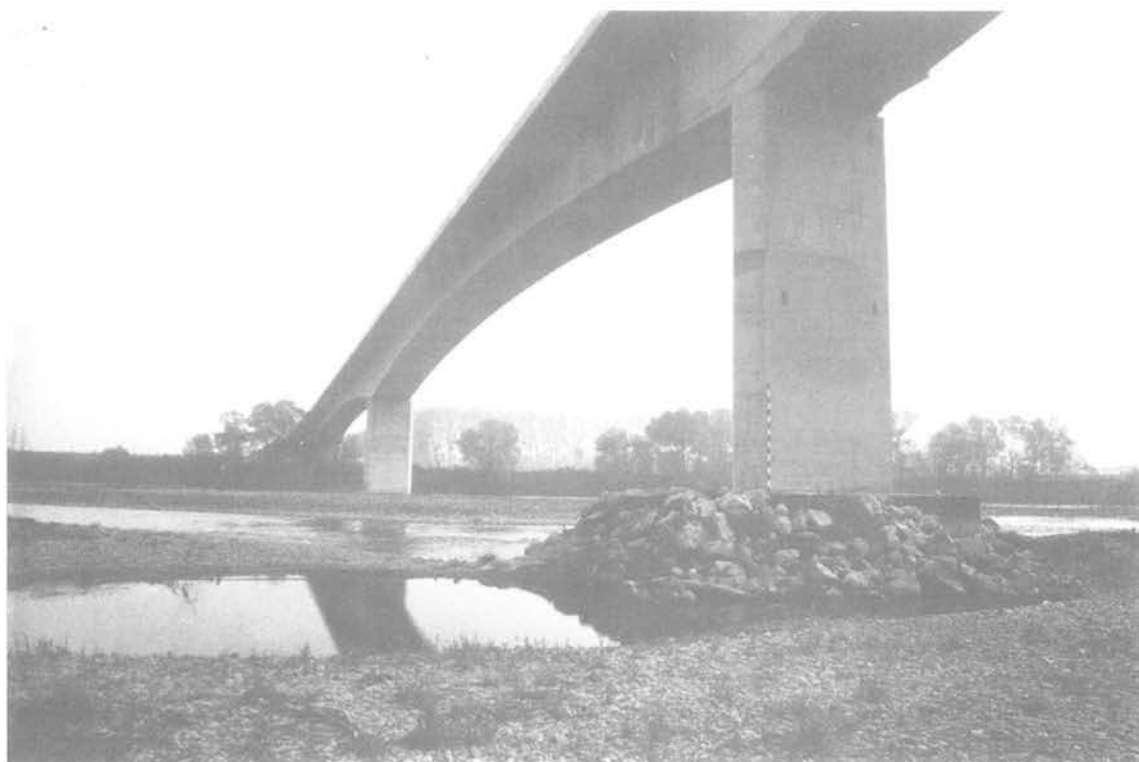
Fig. 2. — Vue partielle de l'ouvrage terminé : viaduc de franchissement de la Garonne à Bourret (au premier plan : pile instrumentée).
