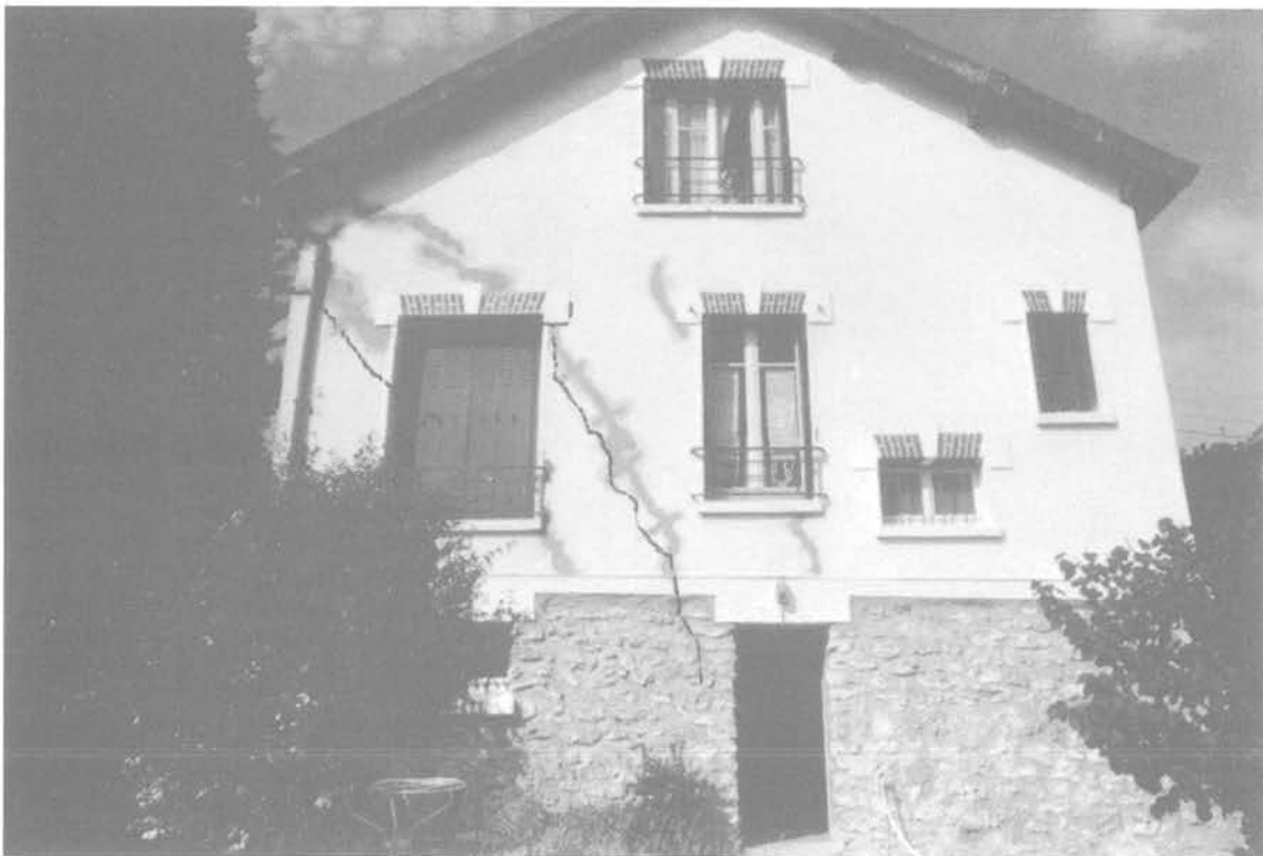
Fig. 6. — (Cliché SIMECSOL). La fissure de l'année 1985 a été colmatée, on a repris en sous-œuvre le pavillon partiellement au moyen de puits trop courts ... et en 1989 une nouvelle fissure, parallèle à la précédente est apparue. Pavillon situé à Montgeron (Essonne) et fondé sur les argiles vertes.
