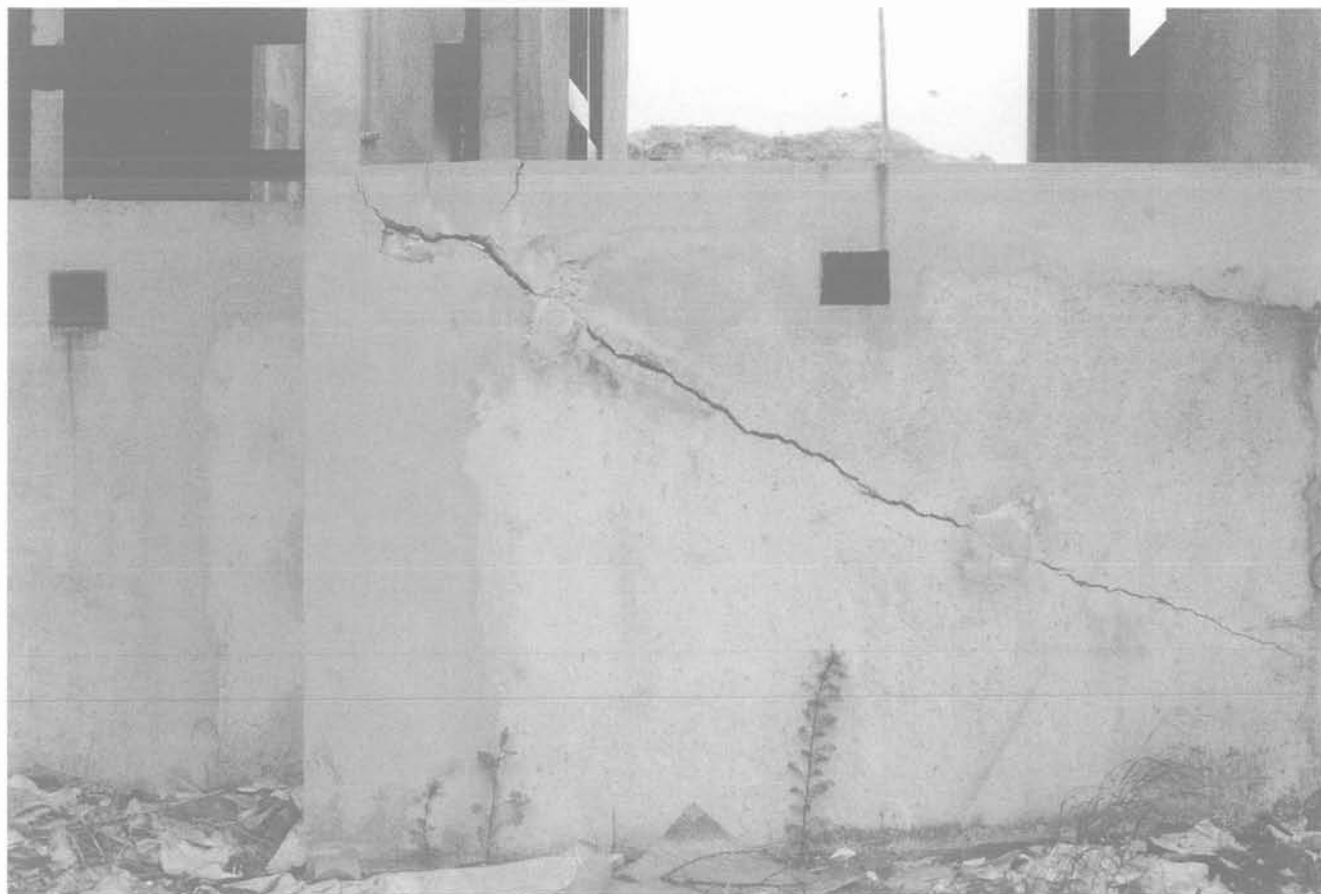
FIG. 4 Désordres dans les soubassements. Damages in the basements.
