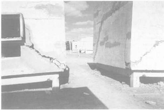
FIG. 10 Perte de verticalité des studios, provoquée par un gonflement différentiel du sol. Loss of verticality of the studios due to a differential heaving of the soil.
