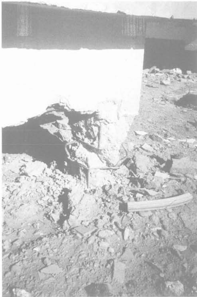
FIG. 11 Rupture par compression d'un poteau d'angle. Failure by compression of an angle column.
