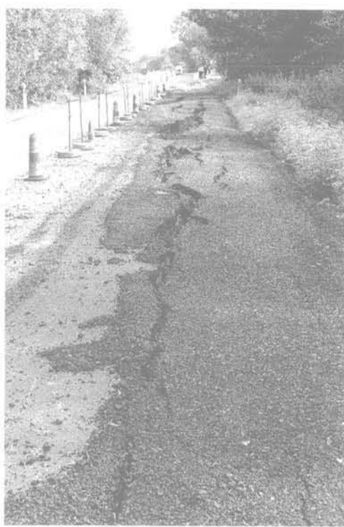
FIG. 11 Glissement sur la route nationale n° 338 (Lubiąż-Kawice) : caractère des destructions du revêtement de la chaussée. Embankment landslide in the national road n° 338 (Lubiąż-Kawice). The nature of road surface distortions.
