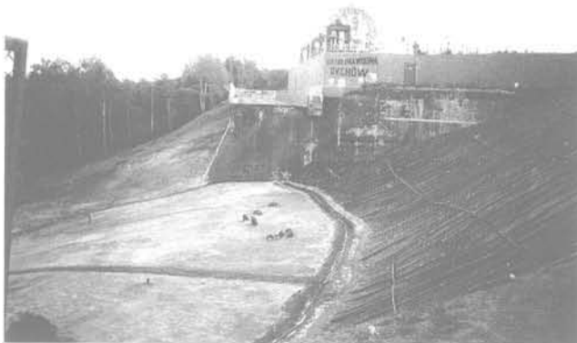
FIG. 3 Vue du glissement du remblai routier à côté du flanc de la chambre d'entrée (« fermeture d'eau »).
