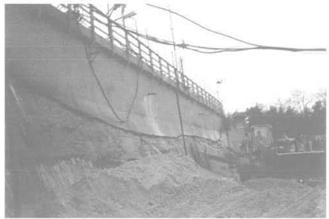
FIG. 5 Travaux de terrassement de la reconstruction du remblai routier. Earthworks in reconstruction of the road embankment.
