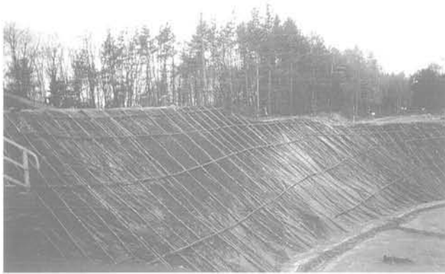
FIG. 4 Protection préliminaire du glissement. Preliminary protected of the landslide.
