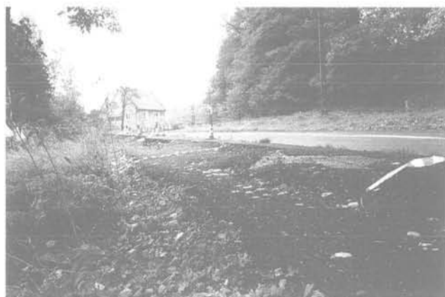
FIG. 13 Vue du trottoir enfoncé du remblai routier côté amont du canal de Nysa Łużycka. Depression view of the embankment from the side of channel of Nysa Łużycka of Nysa Łużycka river.
