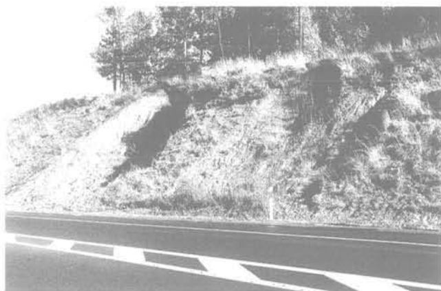
FIG. 12 Vue de glissement du talus routier sur le contournement de Zielona Góra. View of road embankment landslide placed in the bypass of Zielona Góra.
