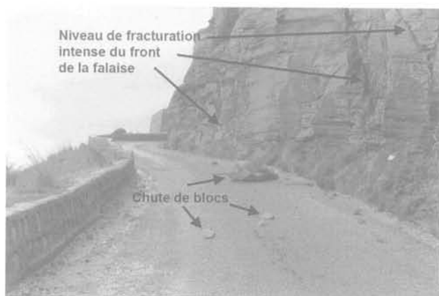
FIG. 3 Chute de blocs de taille variable au niveau de la chaussée en pied de la falaise.
