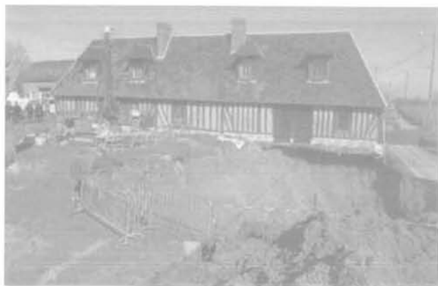
FIG. 1 Fontis de Neuville-sur-Authou (2001). Neuville-sur-Authou sinkhole (2001).
