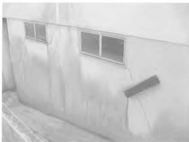
FIG. 4 Vue sur fissure oblique (rampe du sous-sol bâtiment E) avec capot de protection de l'instrumentation. View of disorder and instrumentation.
