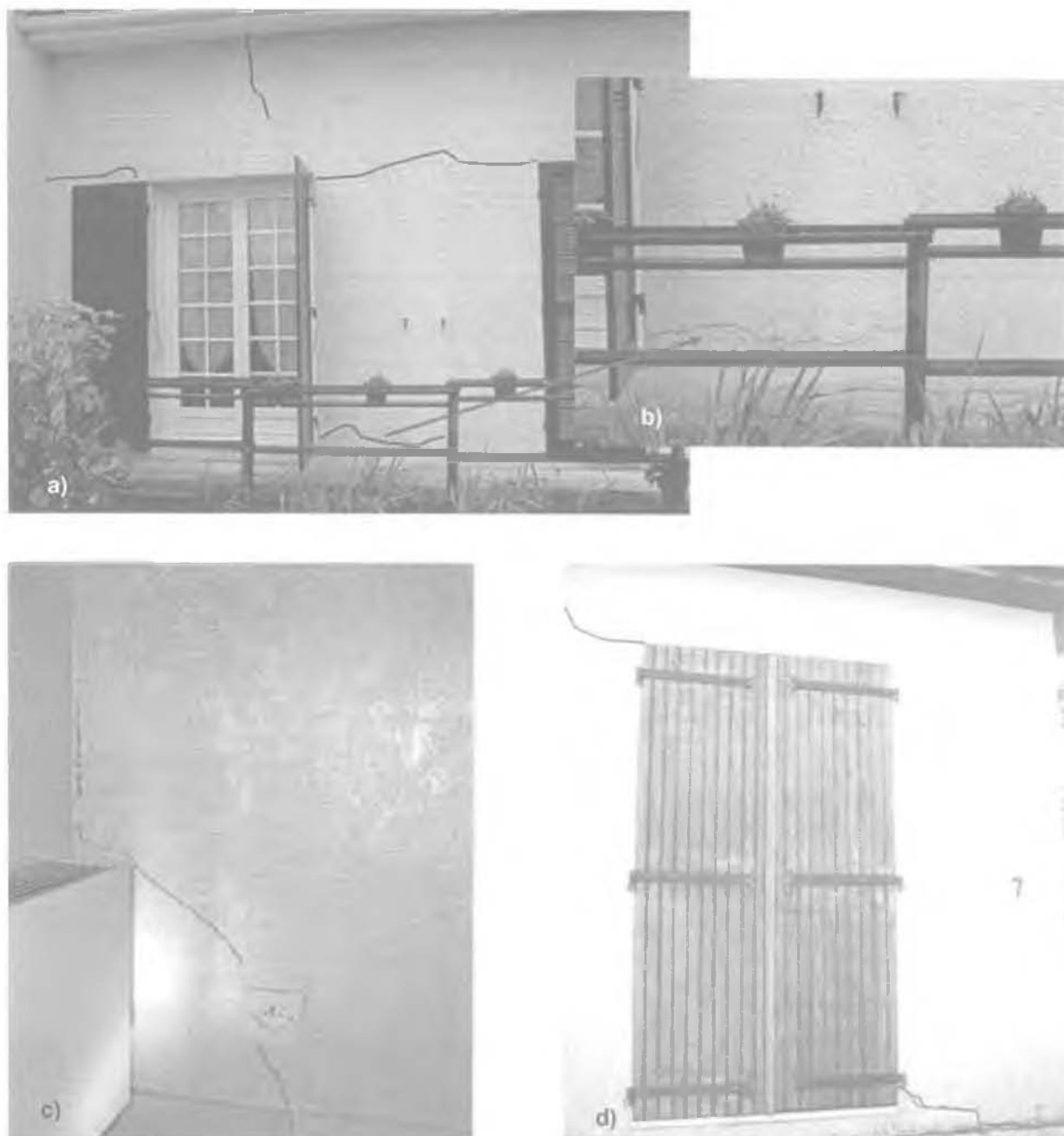
FIG. 5 Exemples de désordres dans les constructions localisées sur le quartier de Cap de Bos à Pessac : a) Fissure verticale haute ; b) Fissures horizontales au niveau du soubassement et des fenêtres ; c) Fissures en diagonale et verticale ouvertes au niveau des cloisons intérieures ; d) Fissures en diagonales. Examples of disorders in buildings localized on Cap de Bos area in Pessac.
