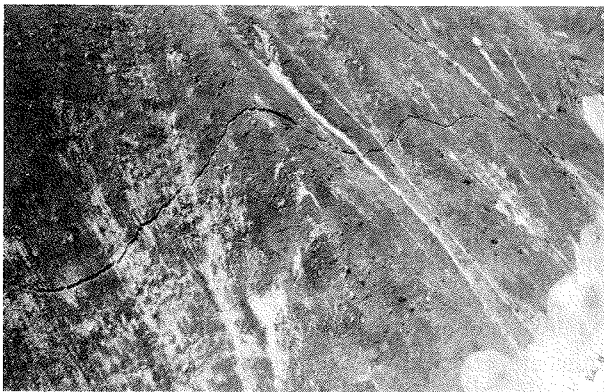
FIG. 15 Retenue EDF de Grand-Maison ; zone instable du Billan, en rive droite, délimitée par la crevasse. EDF Grand-Maison reservoir ; unstable area on right bank, delimited by the crack.
