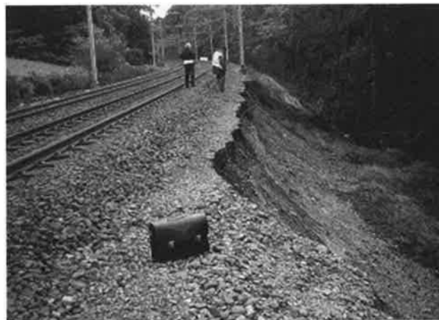
FIG. 1 Glissement d'un talus de remblai. Landslide of an embankment.
